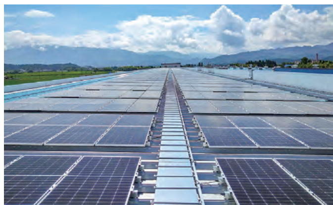
新発田工場屋根太陽光パネル
