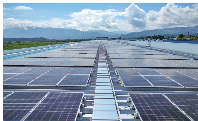
新発田工場屋根太陽光パネル
